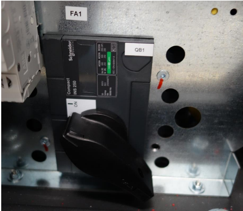
Abbildung 78: Überprüfung des Hauptschalters
